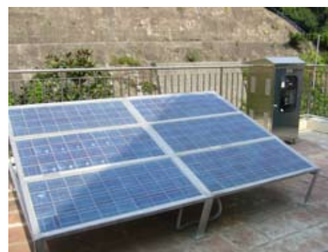
前方是設於天台的大太陽光伏板，後方是發電站
